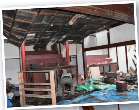
被災寺院本堂内部
